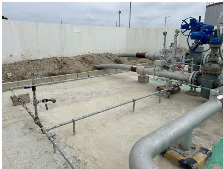
Figura 1.12 Tubería de poliducto y de inyección de químico.
