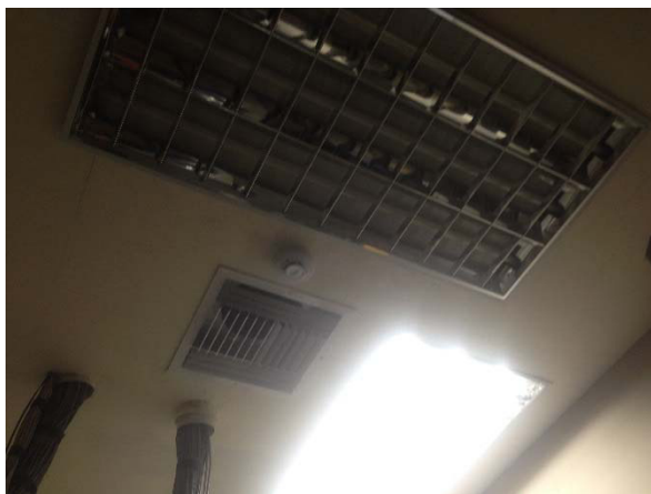
Figura 3.5 Sistema de climatización, iluminación y contra incendios
