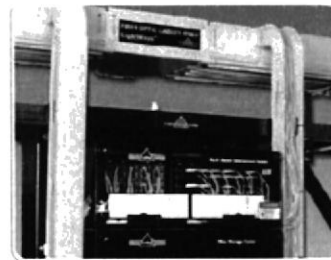
Canal para cable de fibra
