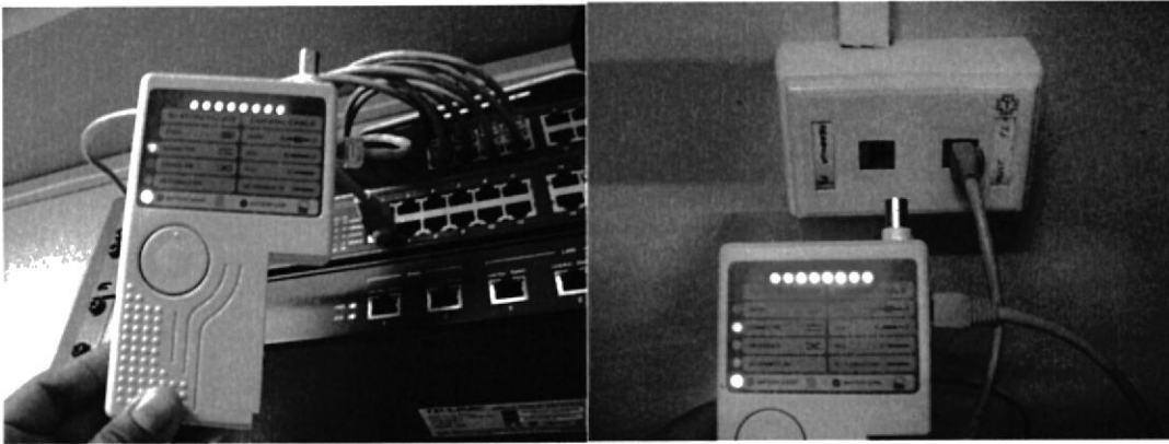
Fig4.5: Prueba de conectividad con el tester (comprobador).
