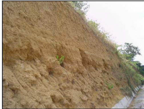
Figura 4.1.2 Caída de volúmenes por proceso erosivo.
