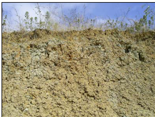
Figura 4.1.1 Efectos de pérdida de Humedad que disponen al talud para su erosión. Talud No.9 (Progreso),
