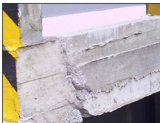
Figura 2.8.26 Detalle grieta en estribo Sección Antigua, Puente Daular
