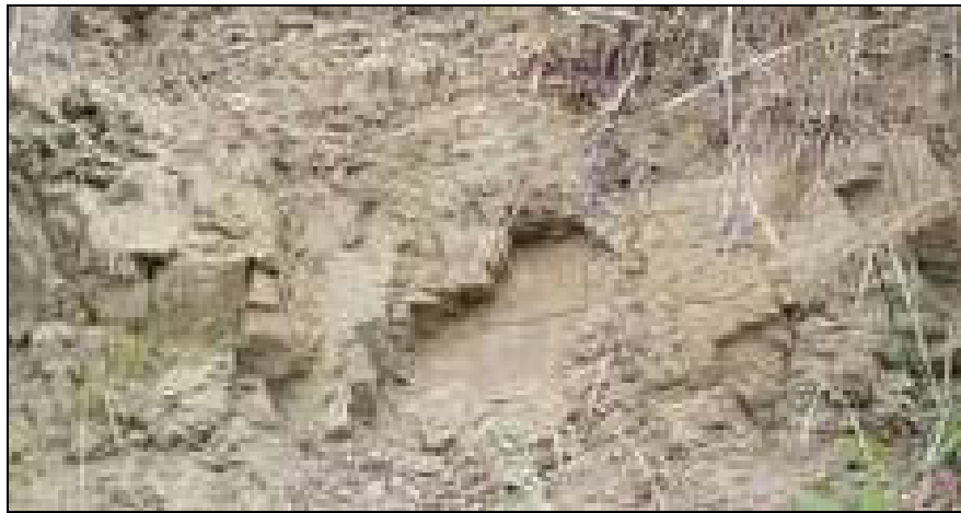
Figura 3.2.1 Detalle de desprendimiento de roca en Talud No. 1,
