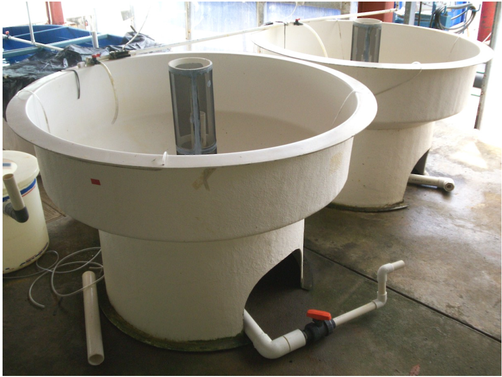
Tanques de filtraje y lavado
