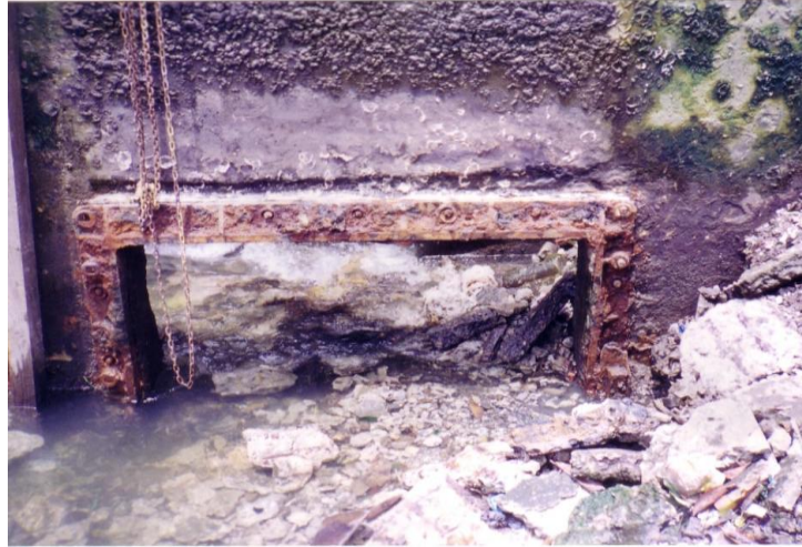
FIGURA 2.15 VISTA DE LA ACUMULACIÓN DEL LODO – DETERIORO DE PERFILES METÁLICOS
