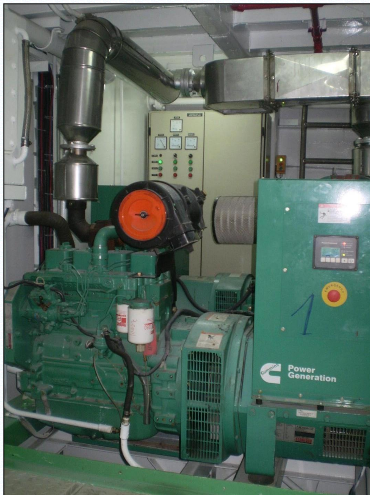
Figura No. 39. Generador Cummings
