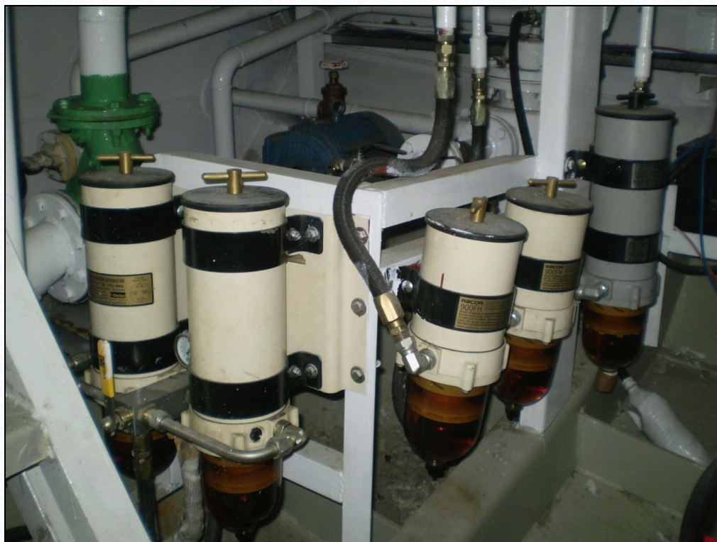
Figura No. 40. Banco de filtros raccor
