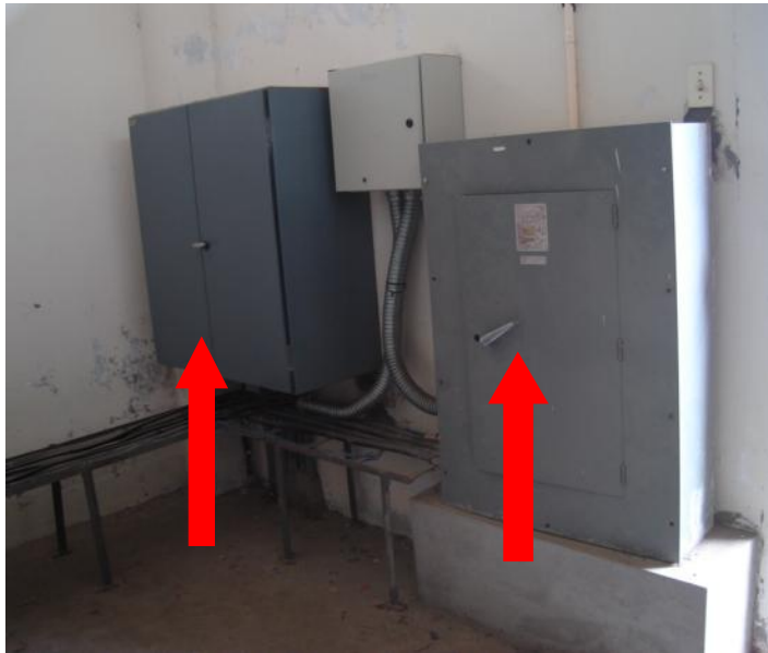
Figura 29. Tableros de distribución sin letreros o señales de seguridad.
