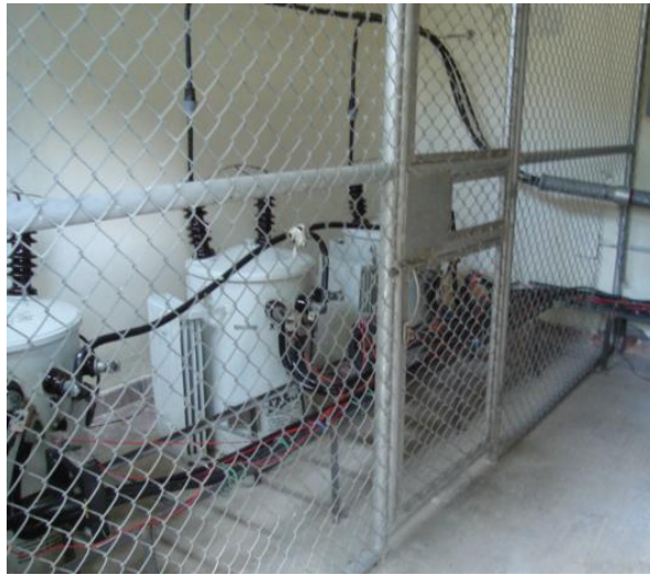
Figura 14. Banco de transformadores en subestación eléctrica Í C/T 22Í .
