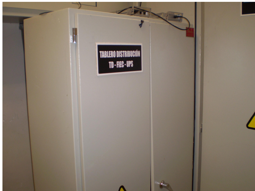
Figura 16. Tablero de distribución de subestación eléctrica tipo Í PadmountedÍ .
