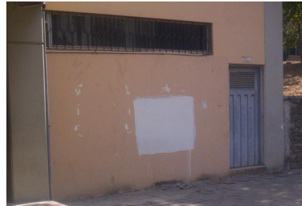
Figura 34. Aberturas de ventilación en subestación eléctrica Í C/T 21Î .
