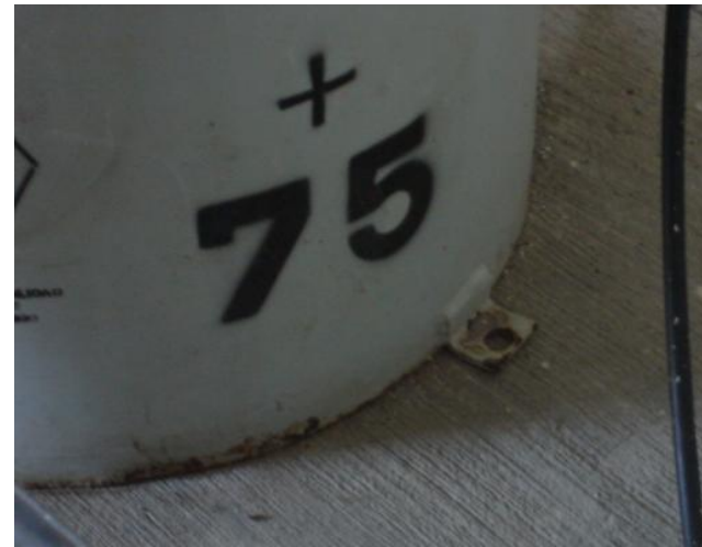
Figura 36. Corrosión en base de transformadores.
