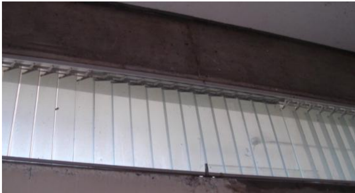
Figura 33. Celosías para ventilación en subestación eléctrica Í C/T 22Î
