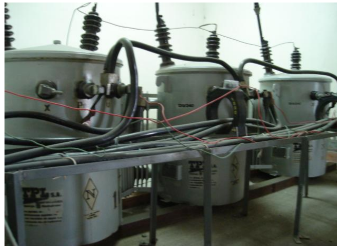
Figura 12. Banco de transformadores en subestación eléctrica Í C/T21Î .
