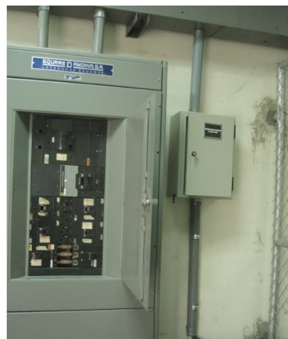
Figura 13. Tablero de distribución en subestación eléctrica Í C/T21Î .
