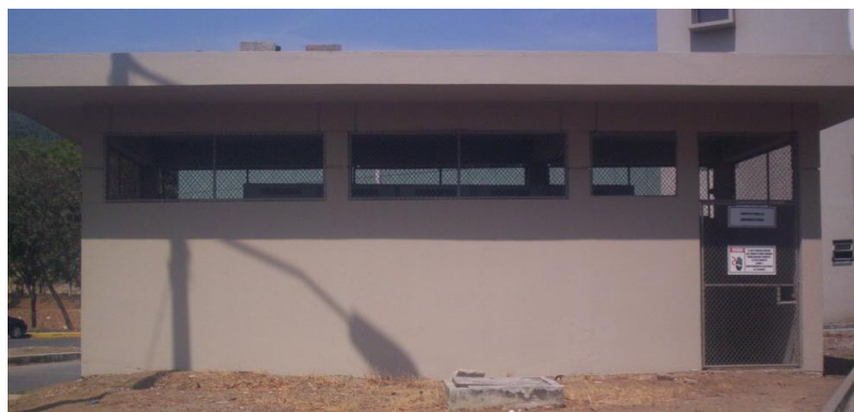
Figura 1a. Celda de media tensión para la FIEC.
