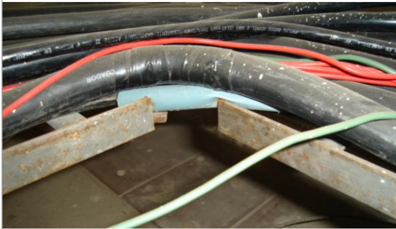
Figura 35. Corrosión en soporte de conductores.
