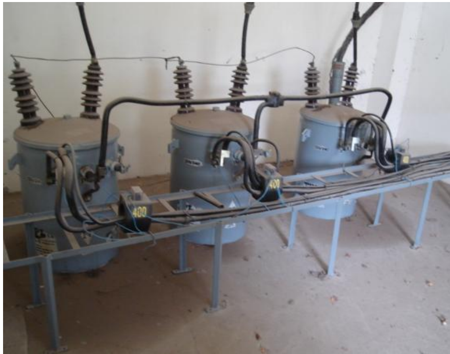
Figura 10. Banco de transformadores de subestación eléctrica Í C/T 23Î .
