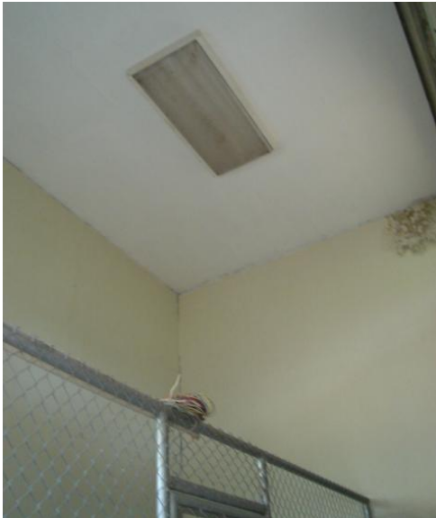
Figura 31. Iluminación mal ubicada en subestación eléctrica Í C/T 21Î .
