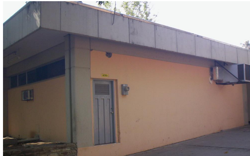
Figura 32. Aberturas de ventilación en subestación eléctrica Í C/T 22Î .
