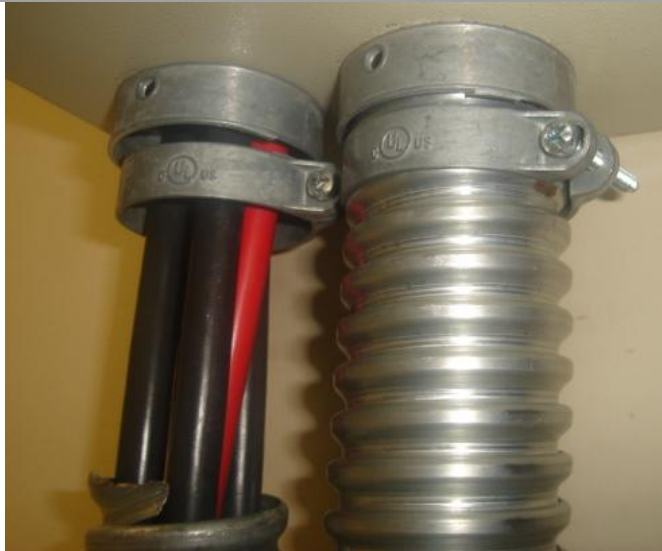
Figura 37. Forma errónea de instalar una funda sellada.
