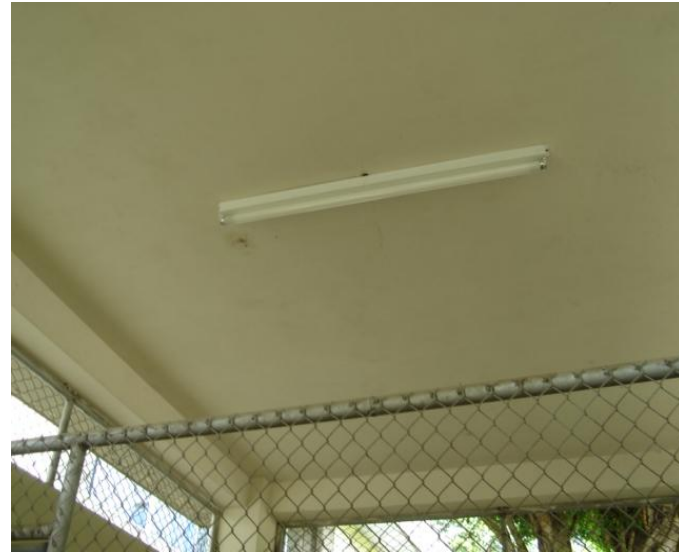
Figura 30. Iluminación insuficiente en subestación eléctrica Í C/T 23Í .
