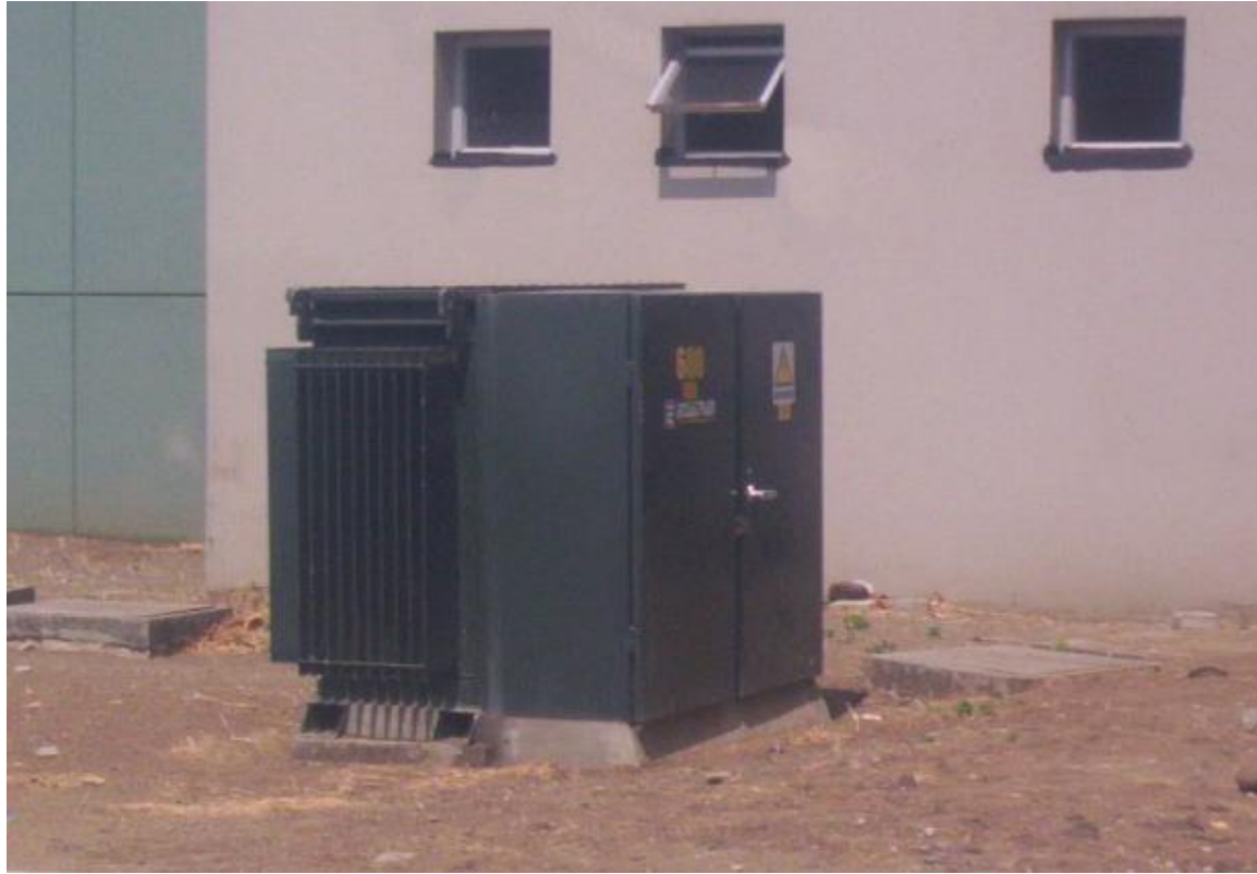
Figura 4. Ubicación de la subestación eléctrica tipo Padmounted.
