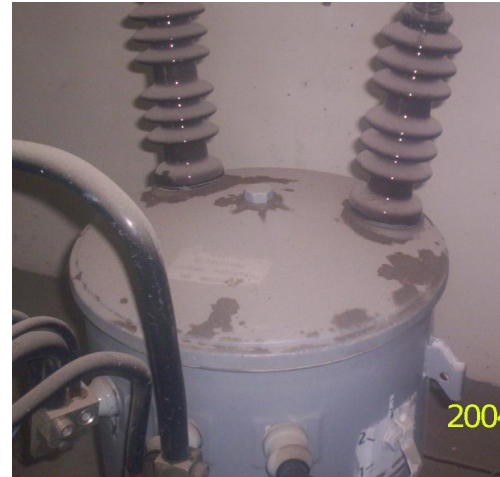
Figura 26. Presencia de polvo por falta de limpieza.
