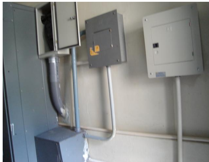
Figura 15. Tablero de distribución en subestación eléctrica Í C/T22Í .
