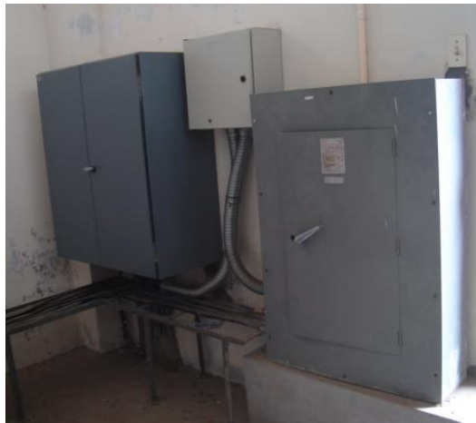
Figura 11. Tableros de distribución en subestación eléctrica Í C/T 23Î .
