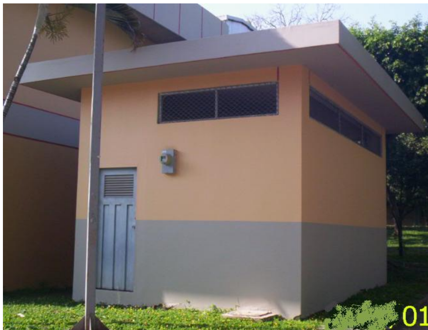
Figura 5. Vista exterior en subestación eléctrica Í C/T 23Î .
