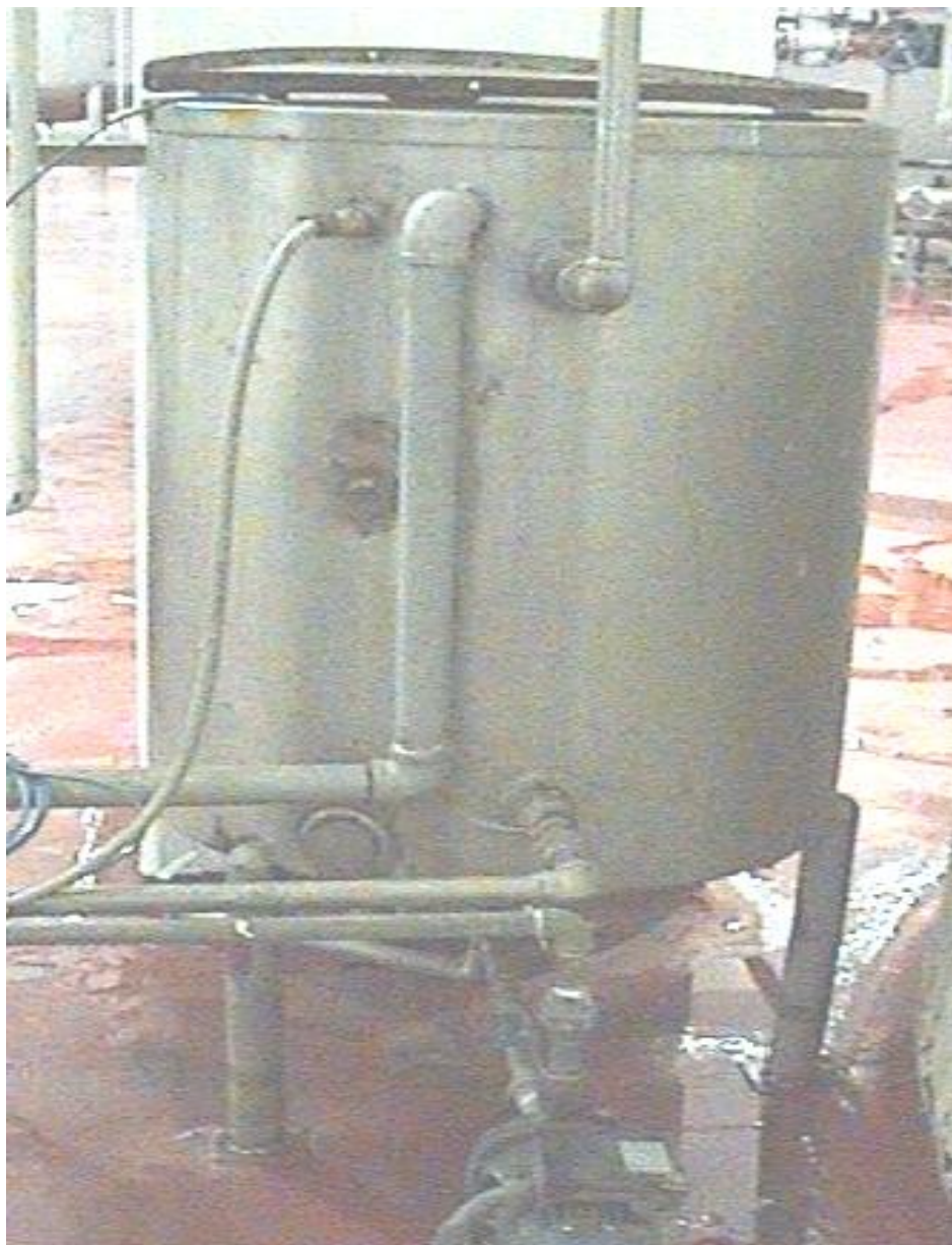
FIGURA 2.5 TANQUE DE AGUA PARA RECIRCULACIÓN.
