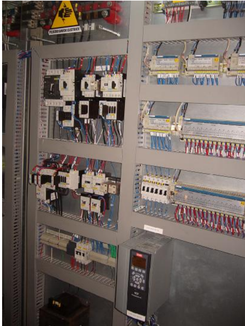
Figura 5.4.- Panel de arrancadores # 2.
