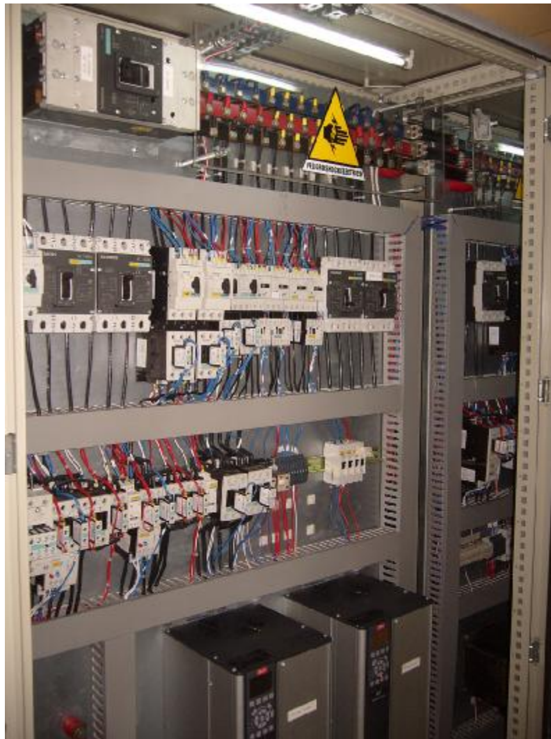
Figura 5.2.- Panel de arrancadores # 1.
