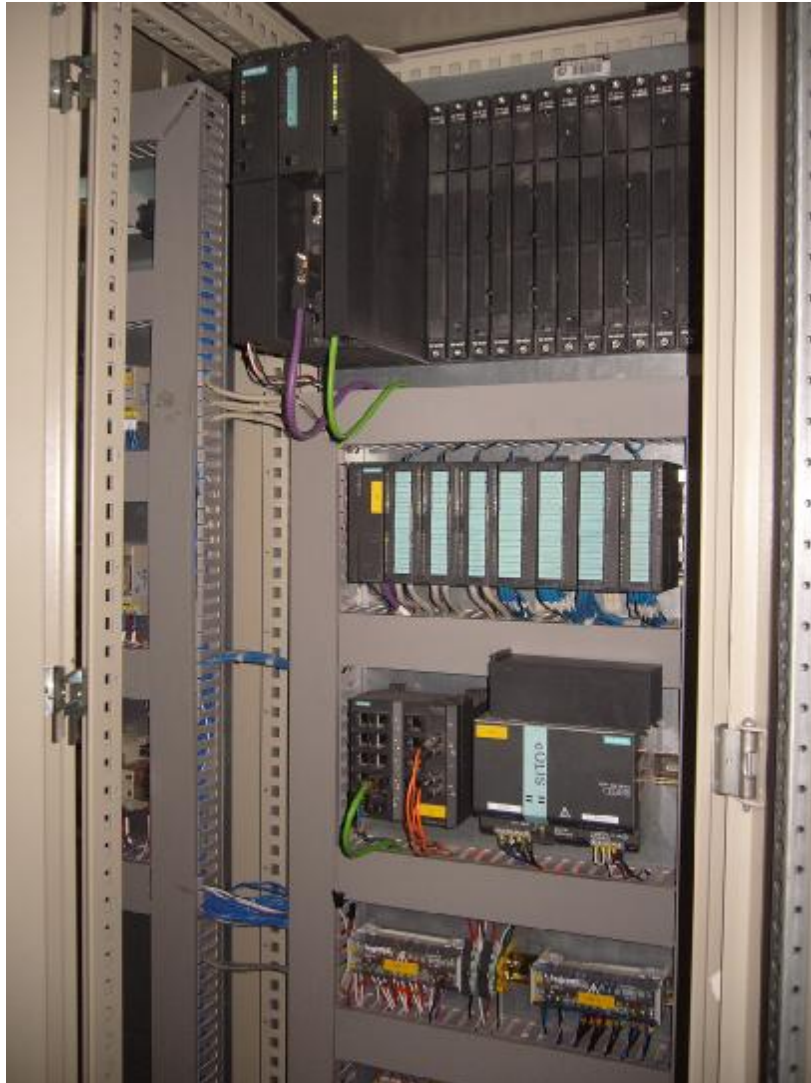
Figura 5.6.- Panel de PLC energizado.
