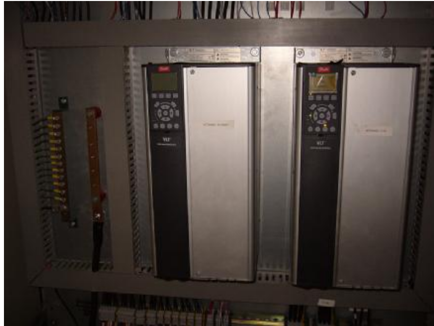
Figura 5.3.- Variadores de velocidad Danffoss FC-300.
