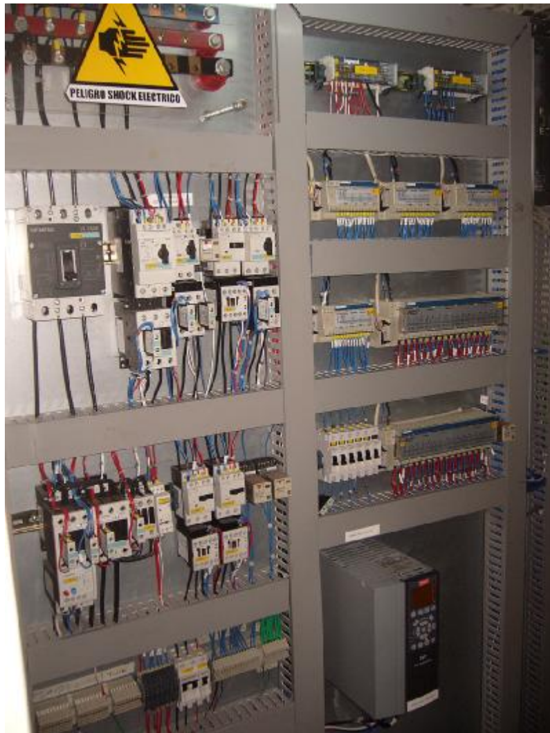
Figura 5.5.- Equipos panel arrancadores # 2 energizados.
