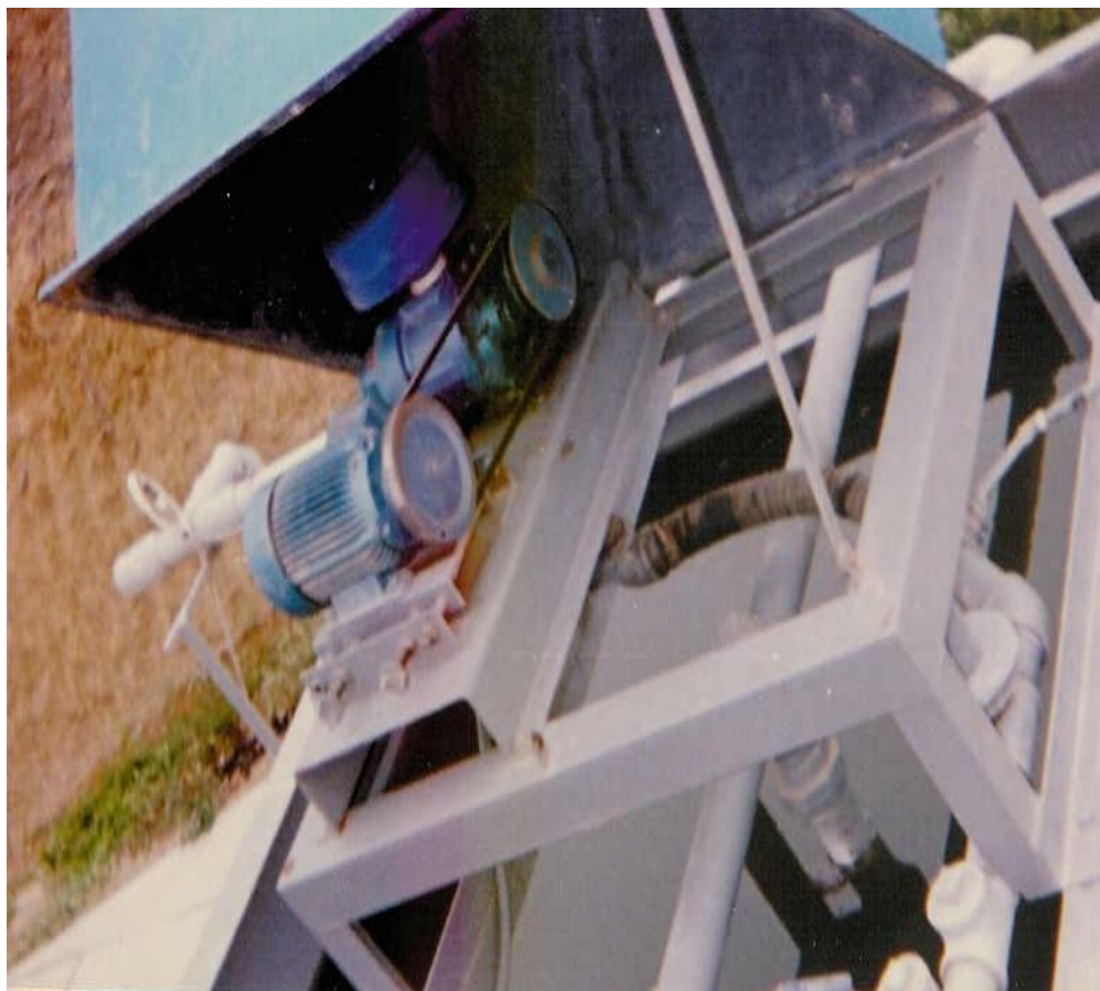
FIGURA 2.9: VISTA DE BASE DE SOPLADOR O COMPRESOR DE AIRE
