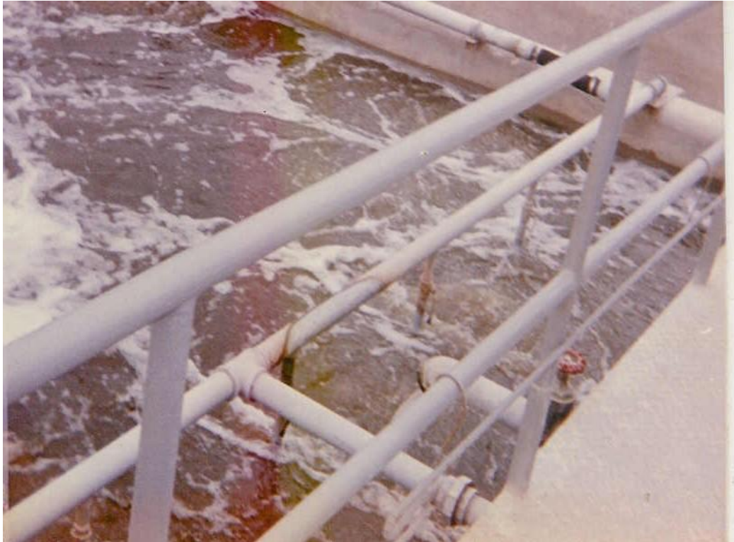
FIGURA 2.4: PUENTE DE MANIOBRAS Y LÍNEAS DE EFLUENTES
