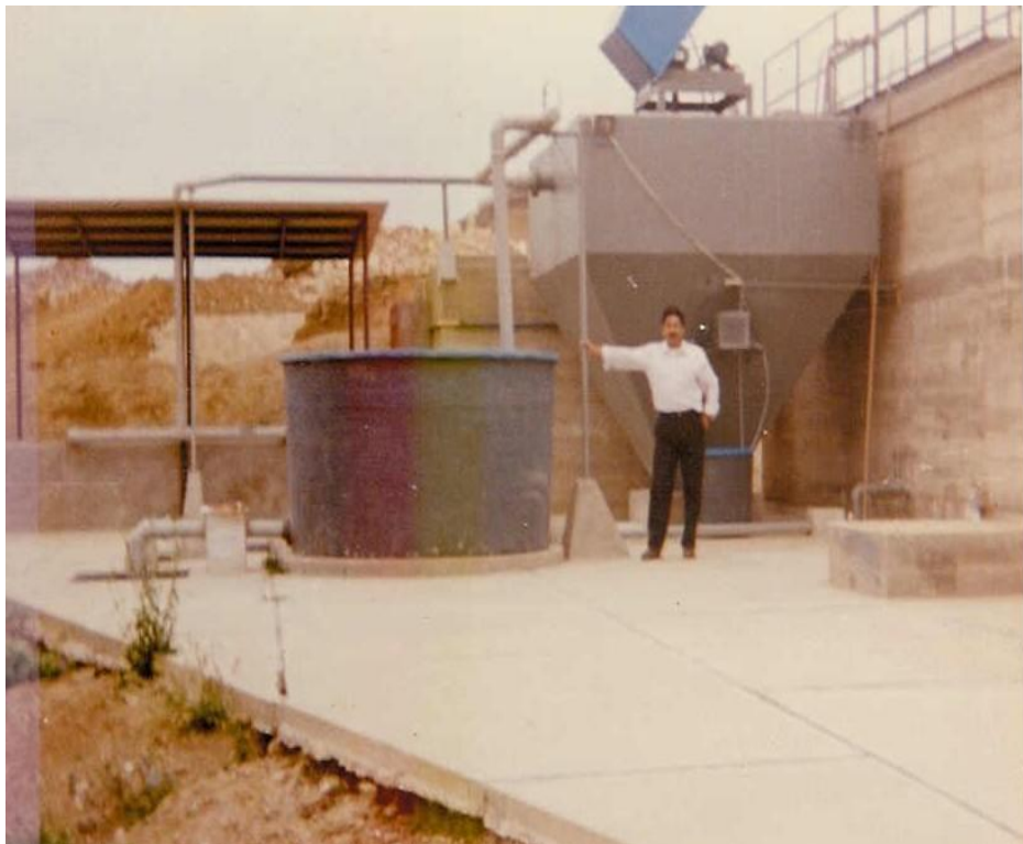
FIGURA 2.1: VISTA DE PLANTA INSTALADA.
