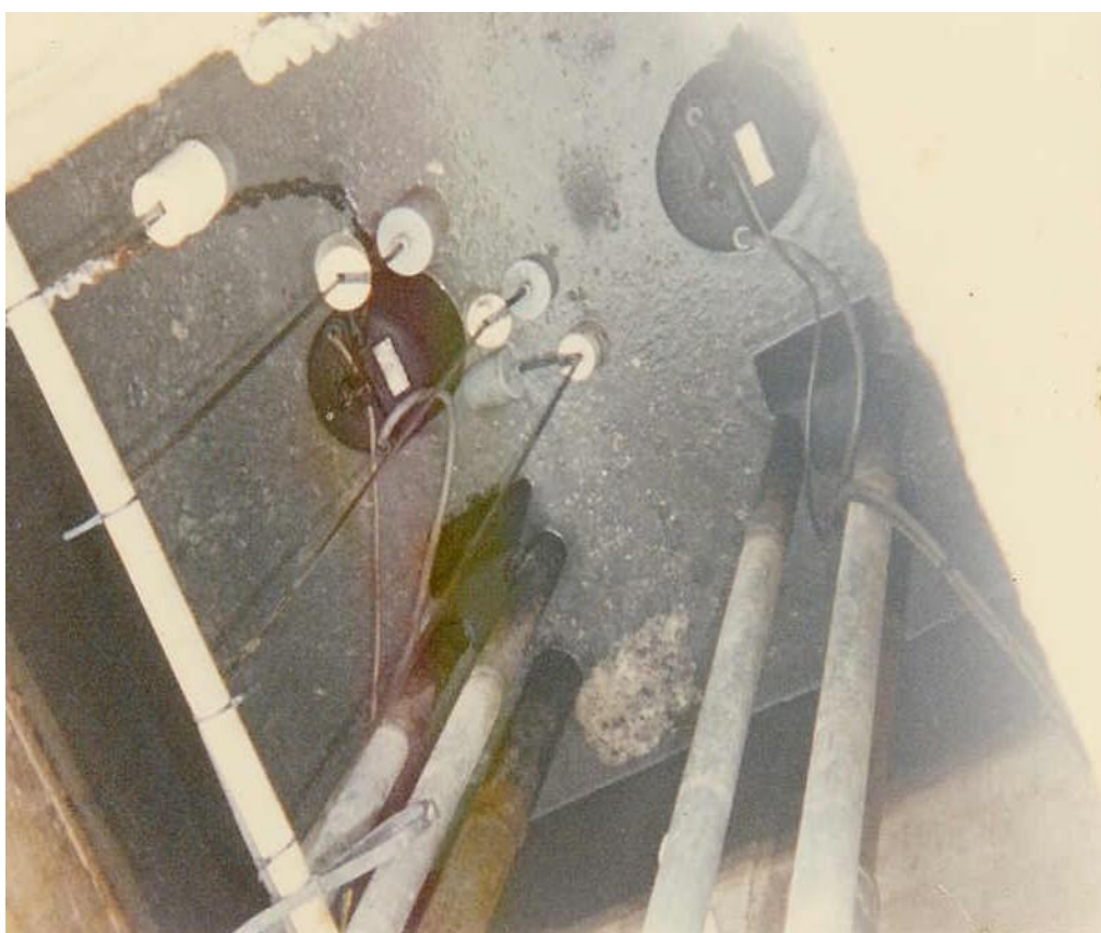
FIGURA 2.6: BOMBAS SUMERGIBLES EN FUNCIONAMIENTO
