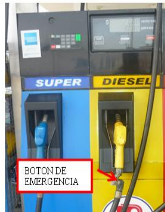
Figura 2.6 Surtidor de combustible
