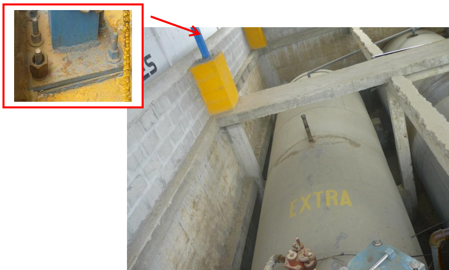
Figura 2.2 Tanques de Almacenamiento
