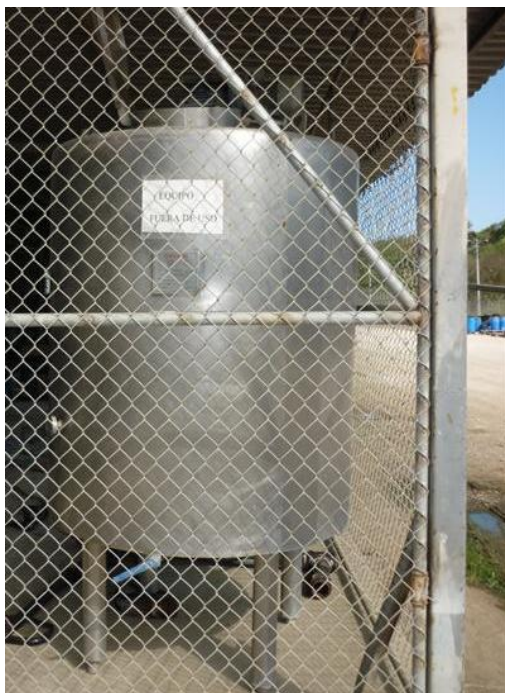
Figura 2.1A: Tanque enchaquetado No operativo vista frontal
