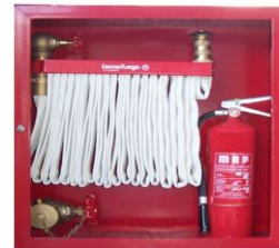
Figura 7. Gabinete de mangueras clase III.
