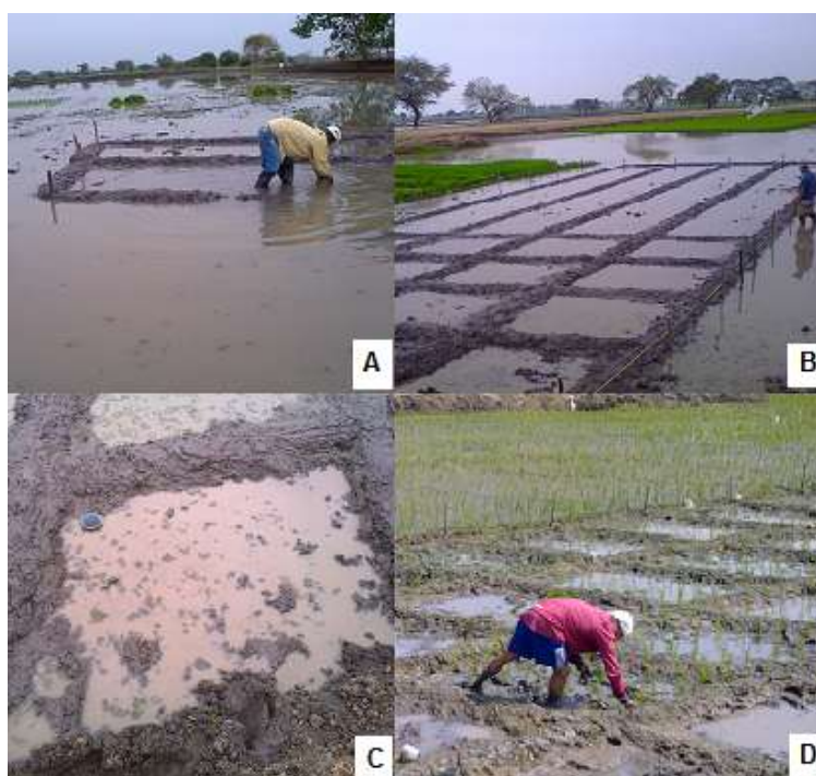
FIGURA. 2.12 (A) LEVANTAMIENTO DE LOS MUROS. (B) CONSTRUCCIÓN DE PARCELAS. (C) PARCELA DE 2MX2M. (D) SIEMBRA DEL ARROZ CON EL MÉTODO DE TRASPLANTE
