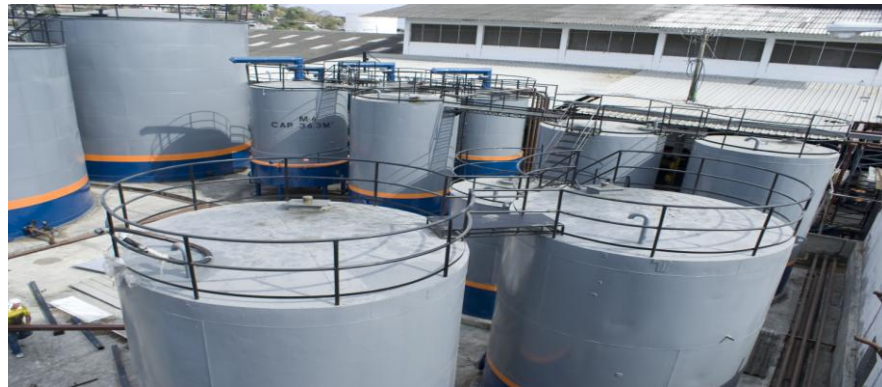
FIGURA 3.1 TANQUES DE ALMACENAMIENTO DE LUBRISA S.A
