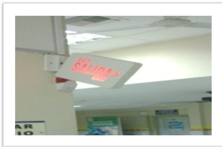
Figura 4.2 Señalética en mal estado Fuente: Maternidad
