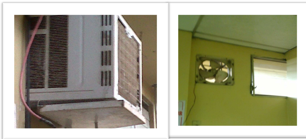
Figura 4.10 Ventilación y su respectivo mantenimiento
