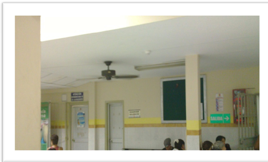
Figura 4.1 Ventilador en mal estado Fuente: Maternidad
