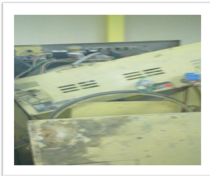
Figura 4.8 Equipos Obsoletos de Lavandería
