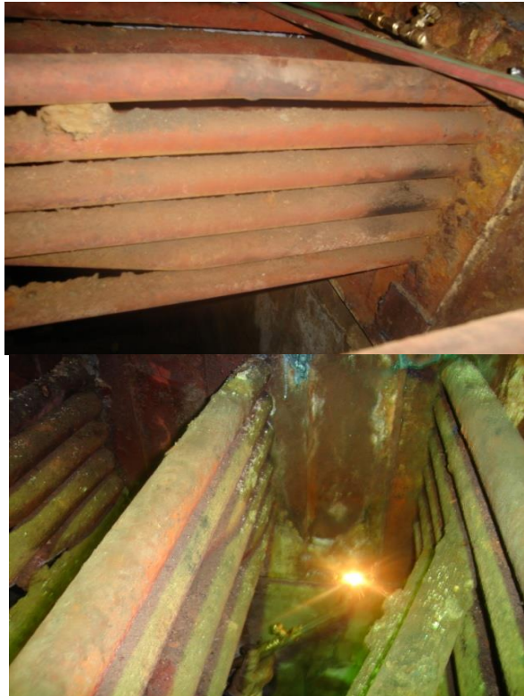
FIG 5.6 SALIDA DE CONEXIÓN SOBRECALENTADOR-COLECTOR EN CÁMARA MUERTA.
