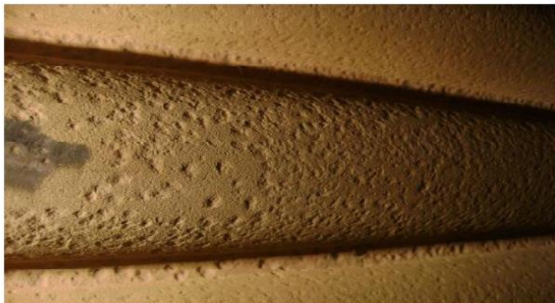
FIGURA 2.13 MECANISMO FALLA POR CORROSIÓN.
