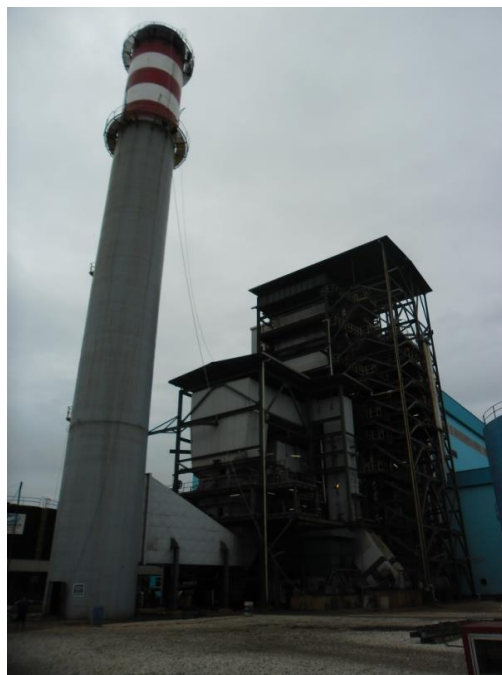
FIGURA 1.1 CENTRAL TÉRMICA TRINITARIA.
