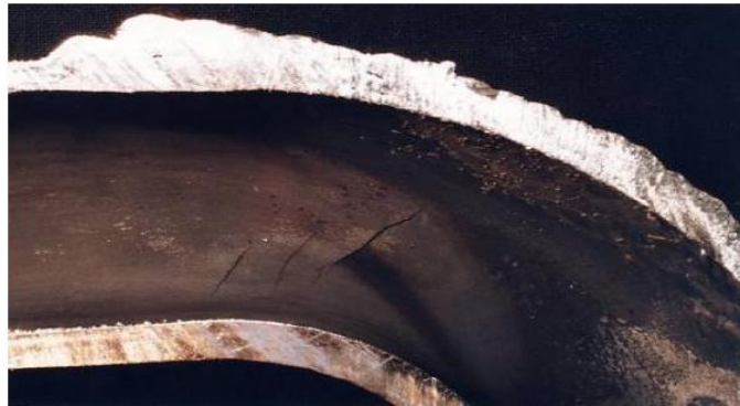
FIGURA 2.10 MECANISMO DE FALLA CORROSIÓN BAJO ESFUERZO.
