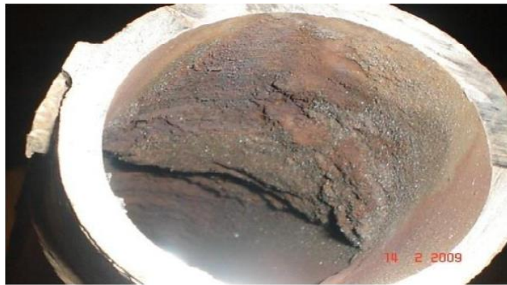
FIGURA 2.7 FALLA POR CORROSIÓN CAUSTICA
