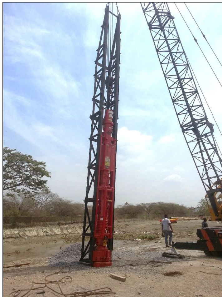
Figura 5.1. Martillo utilizado para hincar los pilotes de la cimentación del tanque de 12000 galones.
