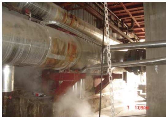
FIGURA 6-3. Tubería de vapor 600 PSI
