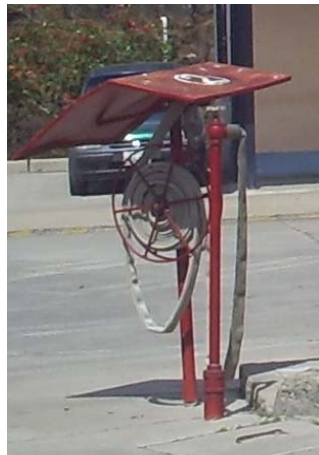
Figura 3.1: Monitor fijo de columna
