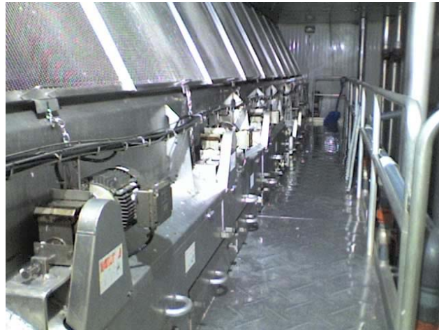
Figura 3.2 Foto del Túnel de congelación
