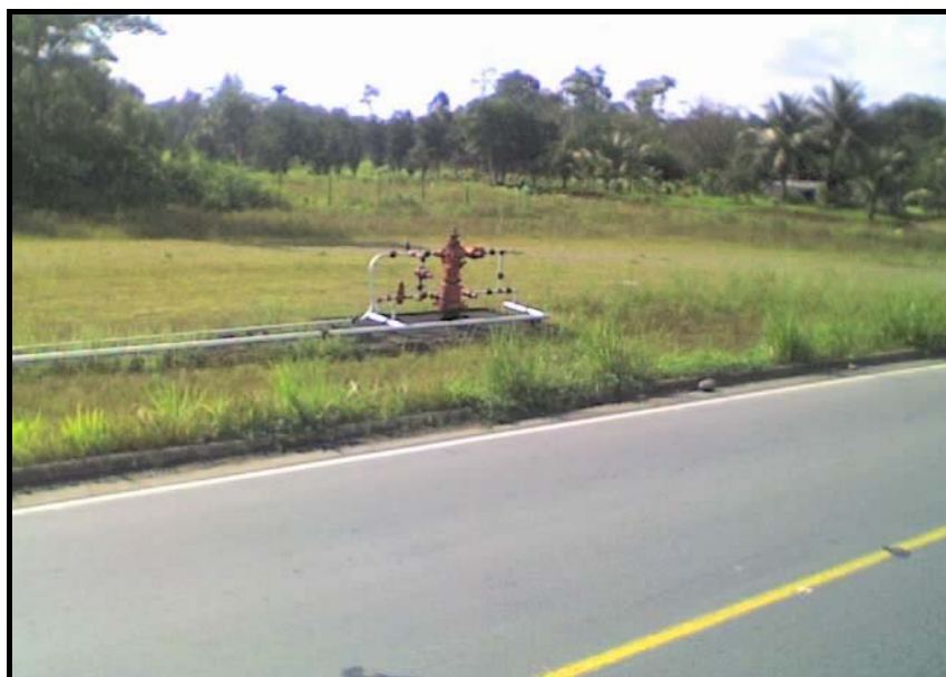
Figura 4.12 Locación pozo SACHA-09
