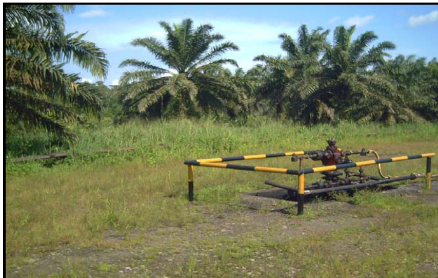
Figura 4.13 Locación pozo SACHA- 43
