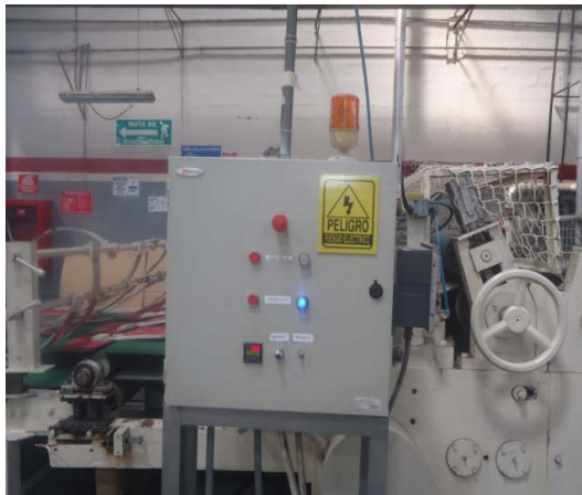
Figura 3.19. Señalética de Riesgo de Eléctrico colocada en tablero de control.
