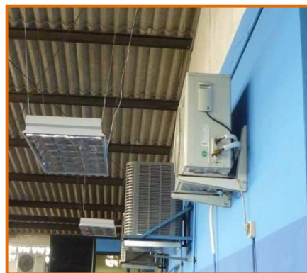
FIGURA 2.15 Compresor cerca de luminaria
