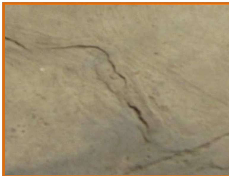
FIGURA 2.13 Piso con grietas.
