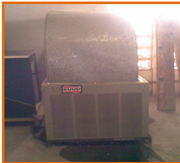
FIGURA 2.8 Una central de aire.
