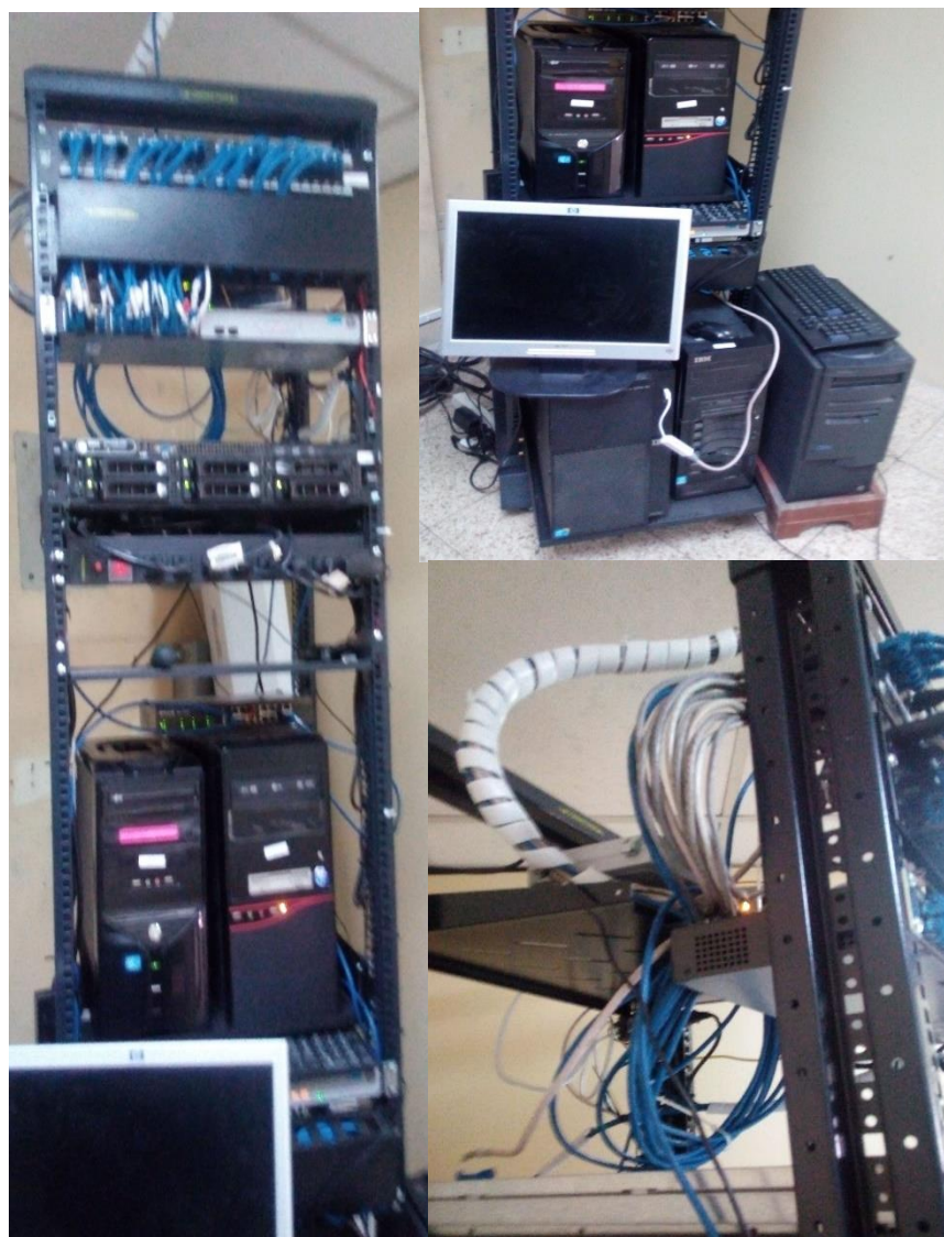
Figura 1.7: Rack y equipos principales de la red.
