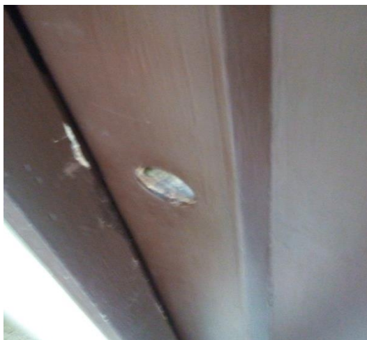
Figura 1.5: Falta de seguridad en la puerta de acceso a cuarto de telecomunicaciones.
