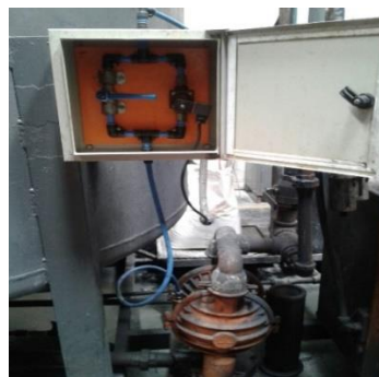
FIGURA 1.6 TABLEROS DE CONTROL BOMBAS NEUMÁTICAS
