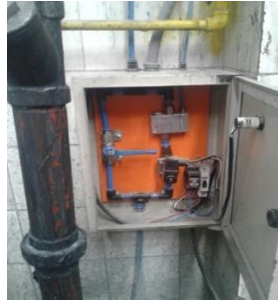
FIGURA 1.5 TABLEROS DE CONTROL CISTERNAS
