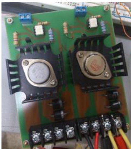
FIGURA 3.25. Conexión eléctrica del variador de voltaje (PWM) de la bomba con el controlador
