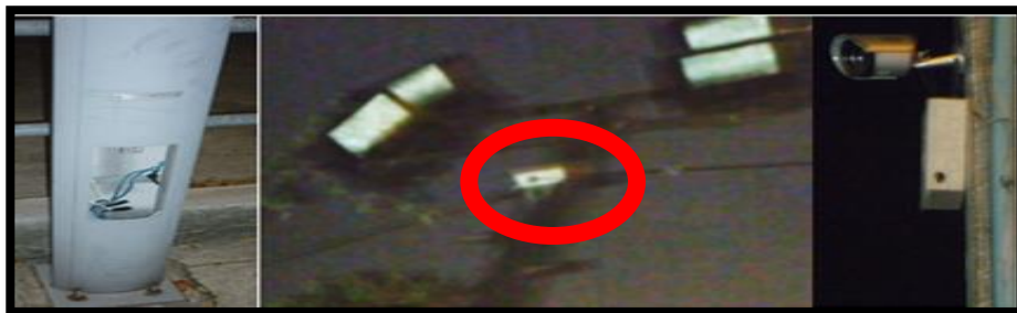
Figura 4. 27 Postes WIFI y postes de alumbrado eléctrico más cámaras
