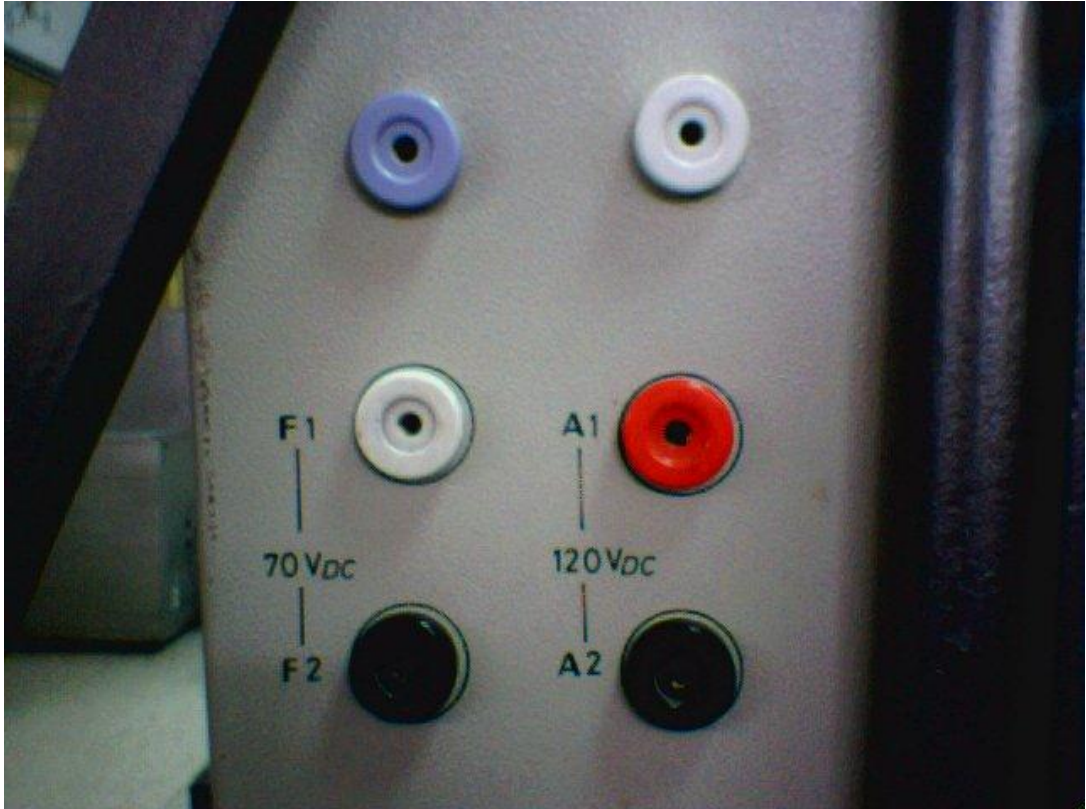
Terminales para las bobinas y la máquina DC
