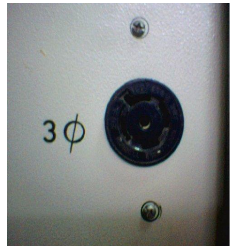
Toma en el tablero
