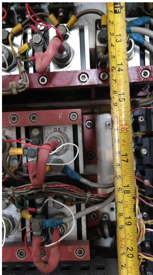
Figura 4.7: SCR montados y listo para retirarlos por falla.
