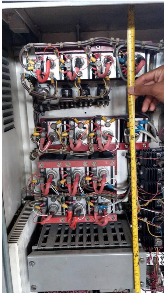
Figura 4.14: Lugar sobre el cual iría montado el variador de frecuencia.
