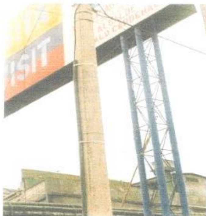
Figura 2.12 Cable de fibra óptica – Tendido aéreo Huaquillas/Tumbéz
