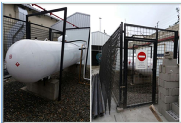
Gráfico 27. Tanque de GLP.
