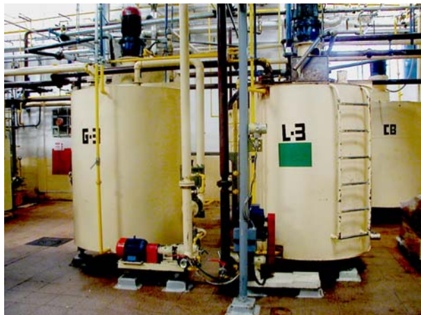
Fig. 1.3.4. TANQUE DE ALMACENAMIENTO
