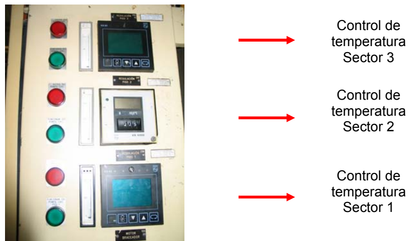
FIG. 3.2 1. CONTROLES DE TEMPERATURA DE SECTORES (TEMPLADORA ASTEED)
