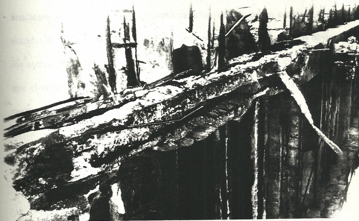
Figura 1.5 Muestra de una viga secundaria completamente corroída.
