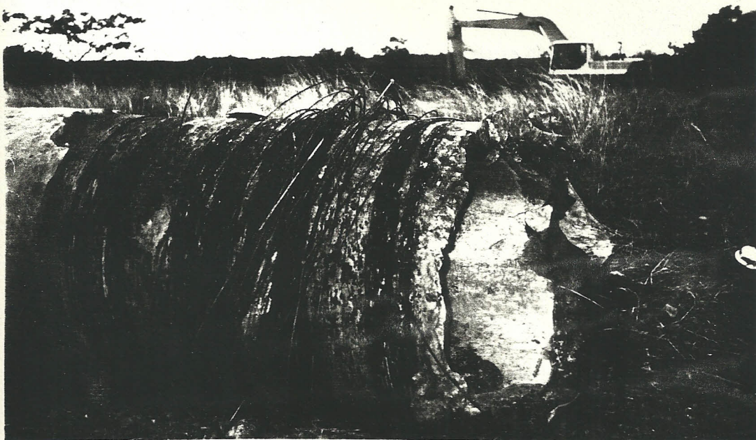
Figura 2.11 Tubería de Hormigón pretensado colapsada por la presencia de cloruros dentro de la mezcla de hormigón
