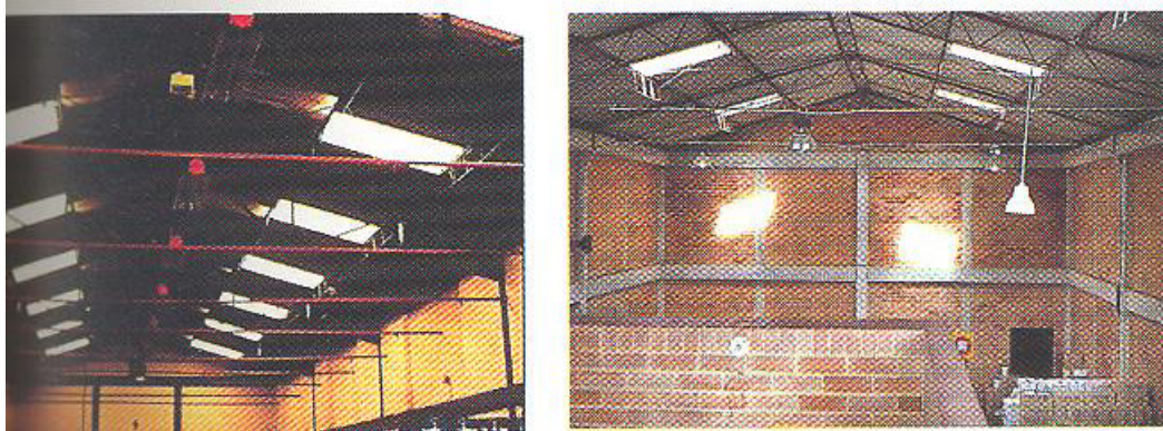
Ilustración 22. Bodega con iluminación natural y artificial
