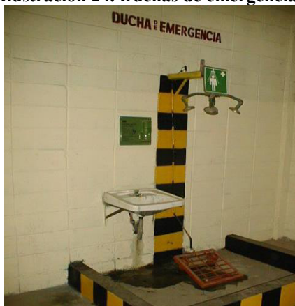
Ilustración 24. Duchas de emergencias
