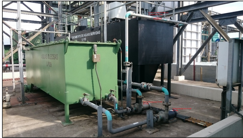
Figura 1.4 Sistema de bombas de los tanques de aguas oleosas y servidas
