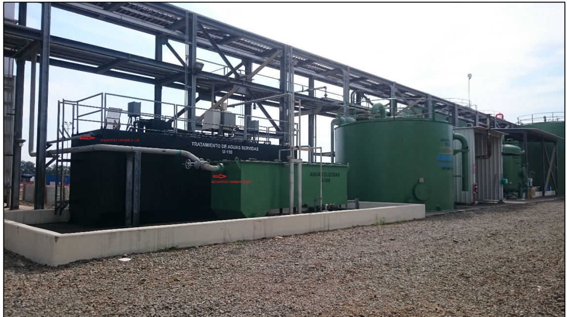
Figura 1.2 Tanques de aguas residuales servidas, oleosas y de rechazo de la ósmosis inversa, que son los afluentes del tanque TK-109
