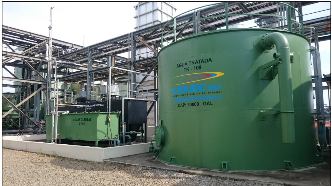
Figura 1.3 Tanque de agua tratada TK–109.
