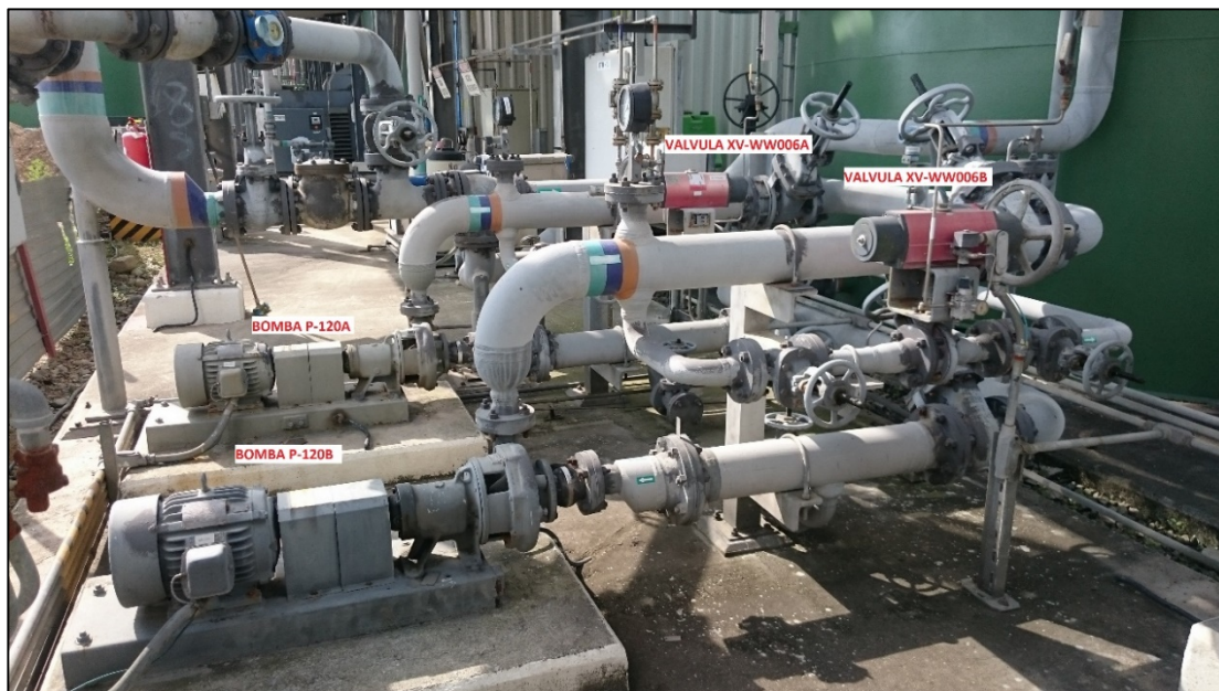
Figura 1.5 Bombas de descarga hacia el mar y válvulas de alivio de presión en línea de descarga del TK-109
