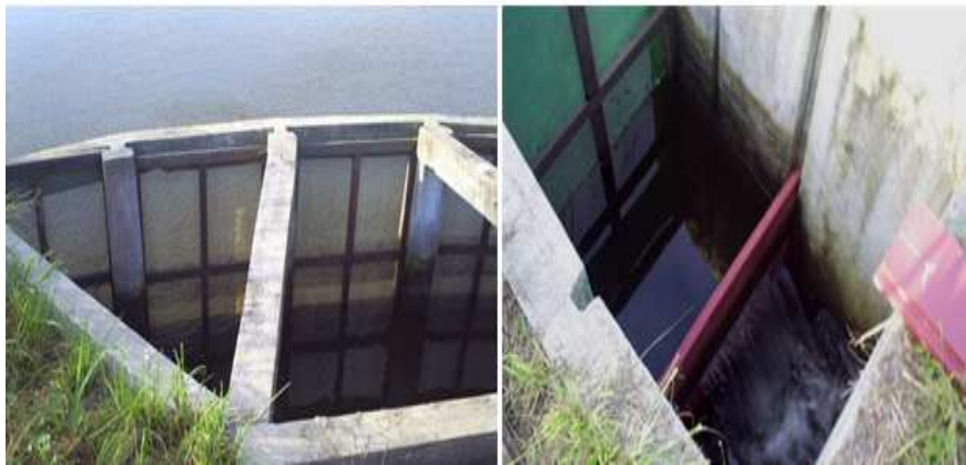
Figura #33: Compuerta de salida de una piscina
