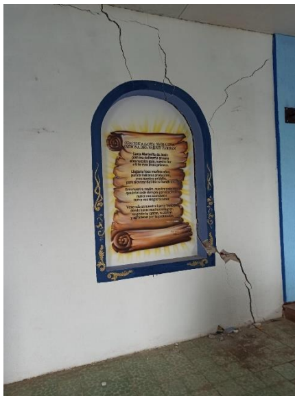
Figura 2.3 Grietas en iglesia [Córdova & Choez, 2021]
