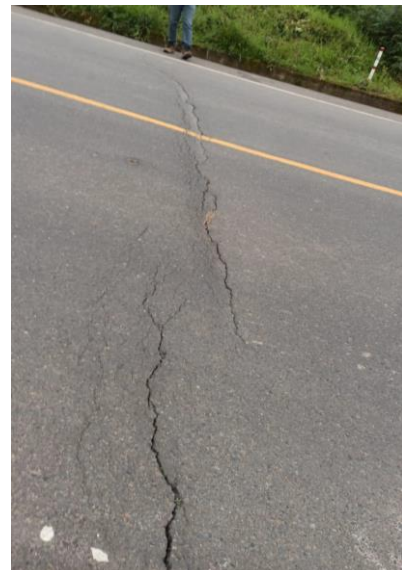
Figura 2.2 Grietas en la vía Chimbo - El Cristal [Córdova & Choez, 2021]
