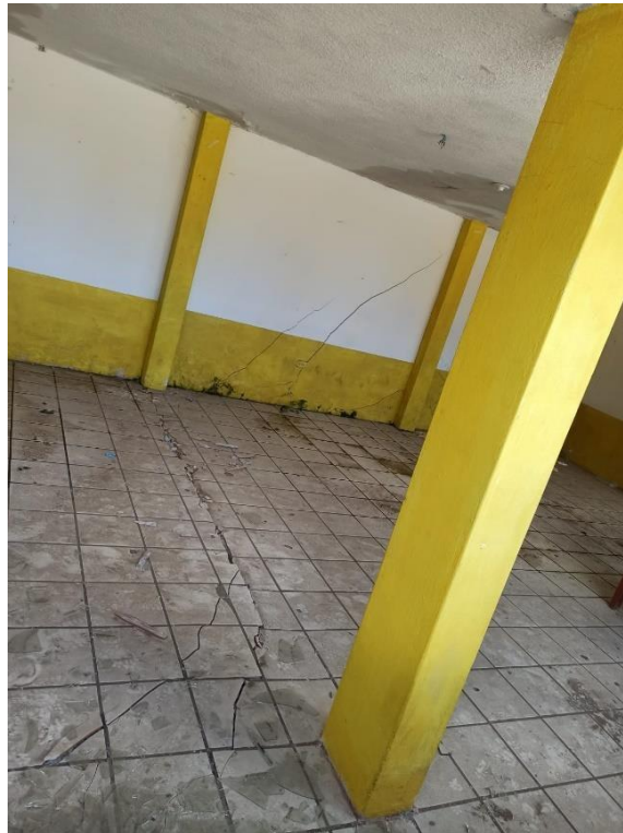
Figura 4.17 Grietas en casa comunal [Córdova & Choez, 2021]
