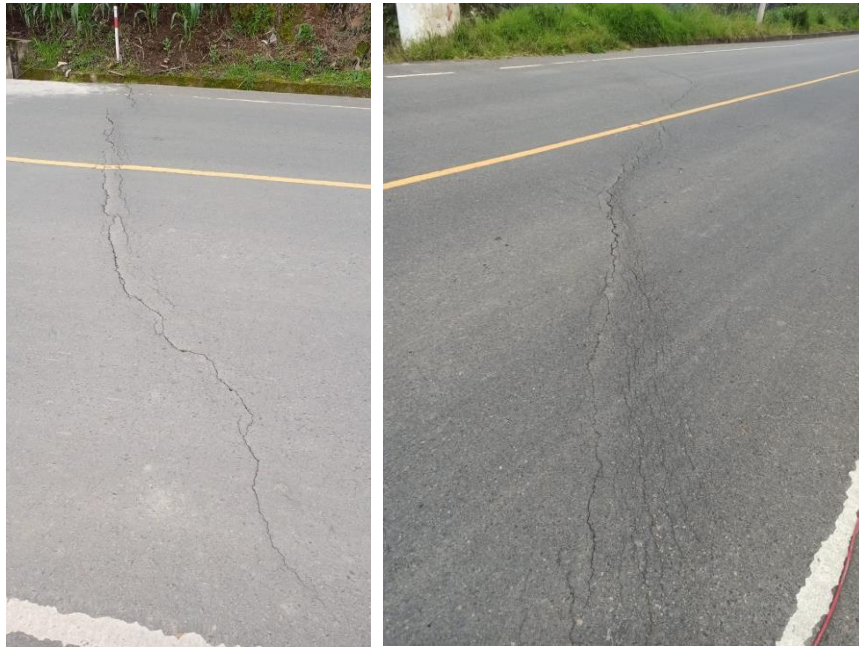
Figura 4.15 Grietas y asentamientos en la vía [Córdova & Choez, 2021]
