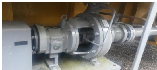
Figura 2. 18 Bomba Booster. Fuente: (Chiriboga, 2015)
