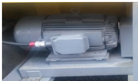
Figura 2. 20 Motor de inducción para la bomba Booster.
