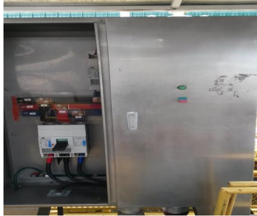
Figura 2. 17 Distribuidor de energía eléctrica Fuente: Rengifo, J., 2017
