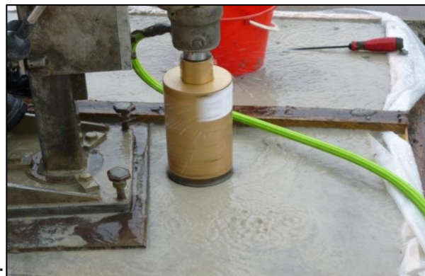
Gráfica 5.20: Calado de Núcleos en la Losa de Pavimento
