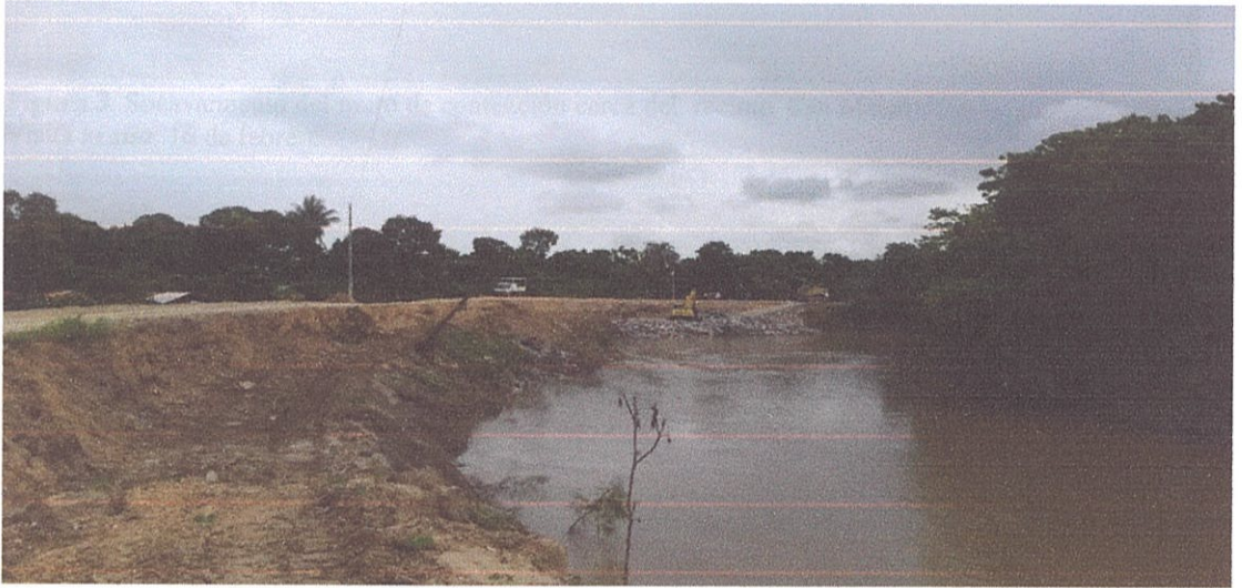
Figura 2. Mejoramiento del muro de contención cerca del recinto San Antonio Visita in situ : 16 de febrero 2016
