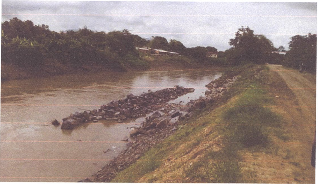
Figura 3. Socavamiento del muro de contención cerca del recinto San Mateo Visita in situ : 16 de febrero.
