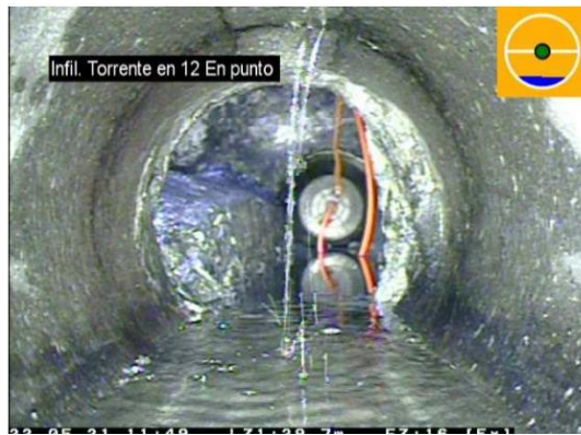
Figura 2.14 Infiltración con un flujo de agua considerable. (INTERAGUA, 2021)
