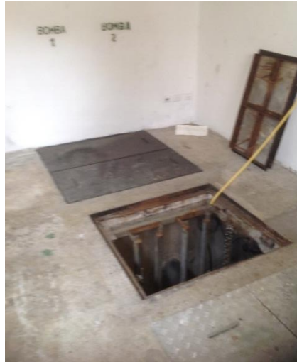
Figura 2.10 Bombas que forman parte de la Estación. (Autores, 2021).
