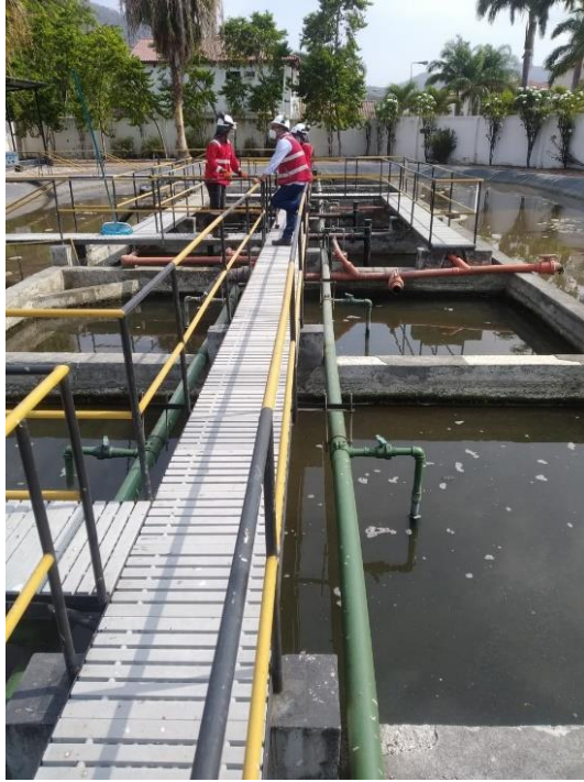
Figura 2.5 Pasarela y Homogeneizadores de la PTAR. (Autores, 2021).
