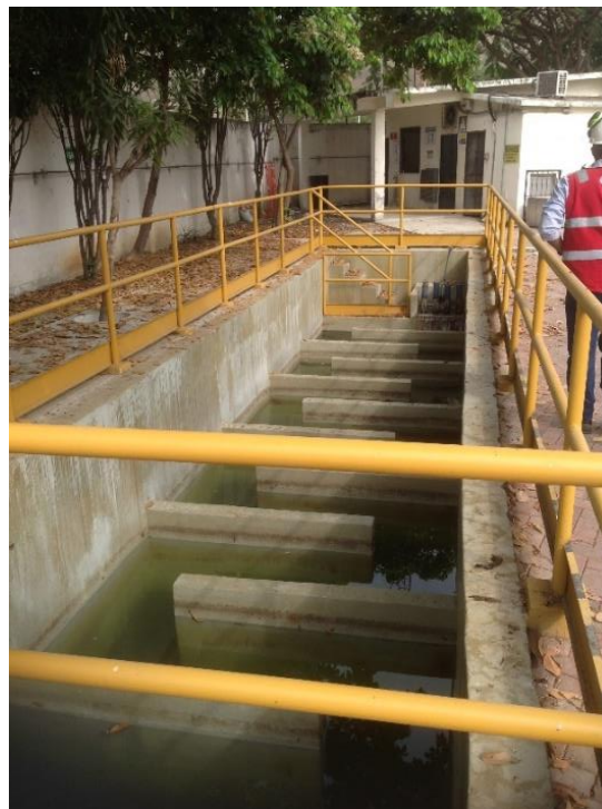
Figura 2.7 Clarificador de la PTAR. (Autores, 2021).
