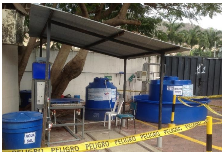
Figura 2.8 Cloro que se usa en la planta de tratamiento de Terranostra. (Autores, 2021).
