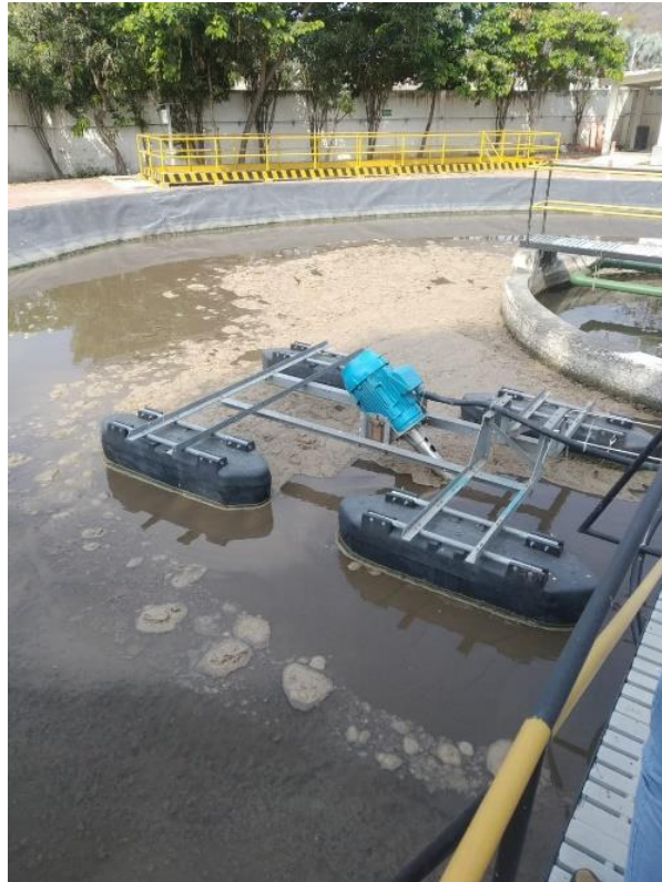
Figura 2.4 Aireadores de la PTAR. (Autores, 2021).
