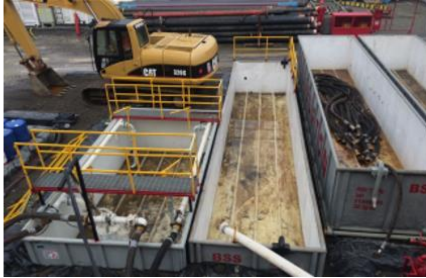
Figura 2-4 Tanques de recepción o catch tanks en pozo Tambococha D6 (2019)
