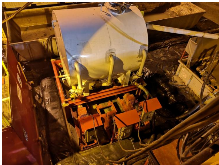
Figura 2-5 Tanques de dispersión en pozo Tambococha D6 (2019)
