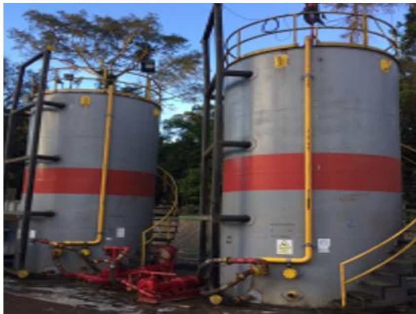
Figura 2-7 Tanques de almacenamiento en pozo Tambococha D6 (2019)
