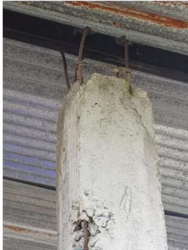
Figura 1.2 Varillas de refuerzo expuestas. [Pelayo & Ashby, 2020]
