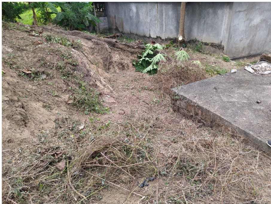
Figura 10. Erosión y construcción de cisterna
