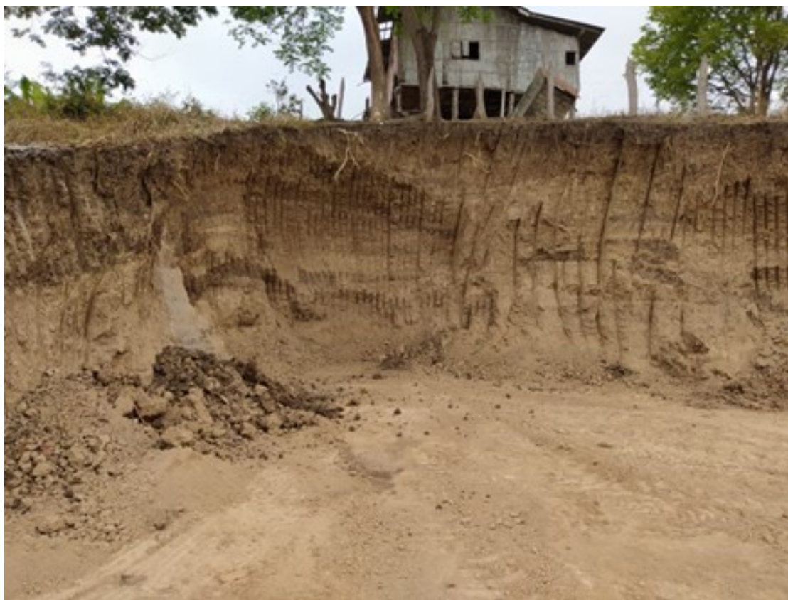
Figura 4.17: Sitio SA-04-155 afectado por la minería de tierra.
