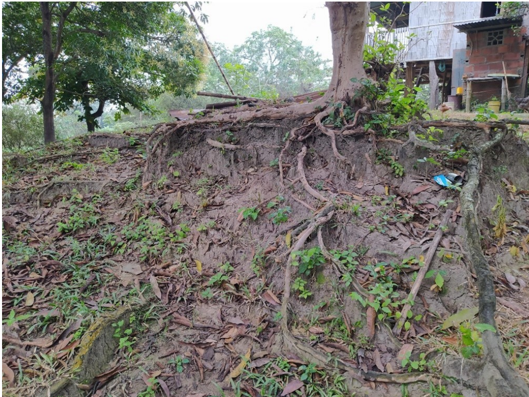
Figura 4.20: Tola afectada por la erosión.
