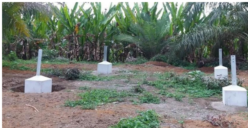
Figura 2.3 Bases y stubs de una torre de transmisión
