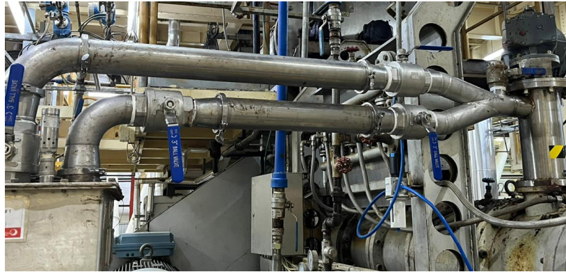
Figura 2.28 Tubería paralela del tubo densificador
