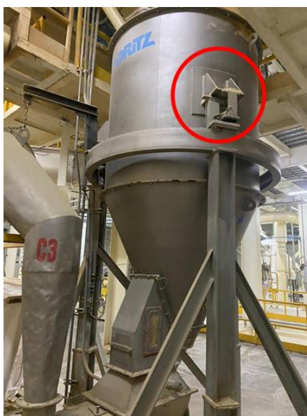
Ilustración 52 Vibrador en tolva de línea extrusora [Fuente: Elaboración de autores]
