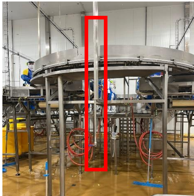
Figura 42 Bajante de presión instalado frente al carrusel
